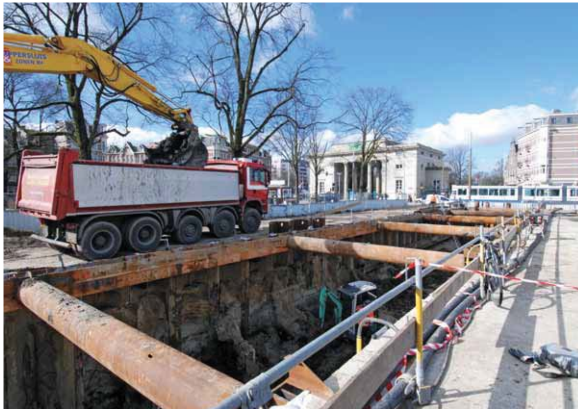
Ontgraving van de bouwput voor het bergbezinkbassin op het Haarlemmerplein, gezien richting Haarlemmerpoort. Onder een 3 meter dik pakket van zoste-eeuwse opgebracht zand lagen de 17de-eeuwse ophogingslagen.
