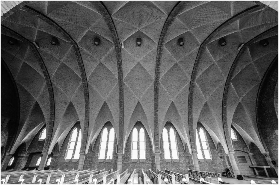
Afb. 4. Het gewelf en daaronder de scheibogen naar de smalle zijbeuk. Foto auteurs.
